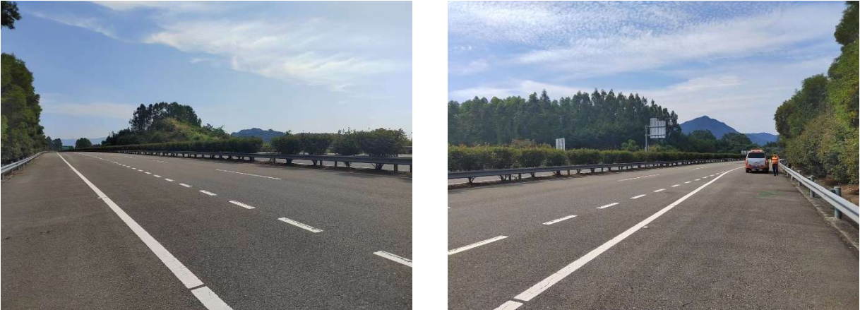
AK802+100-200 二车道路面泛白、细集料剥落
