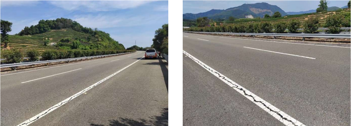
AK804+200-300 二车道路面泛白、细集料剥落
